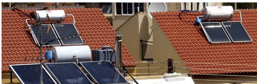
Εικόνα 1. Θερμικά ηλιακά συστήματα εγκατεστημένα σε οροφές κτιρίων στην Κύπρο Φώτο: Χρίστος Χριστοφίδης
