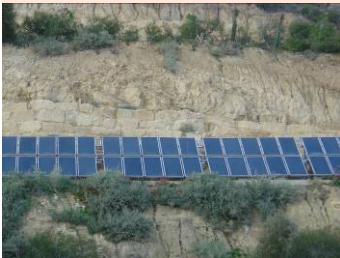
Εικόνα 25. Σύστημα θέρμανσης ZNX με ηλιακά πλαίσια σε ξενοδοχείο στην Κύπρο
