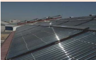
Εικόνα 17. Η πρώτη εγκατάσταση ηλιακού κλιματισμού στην Κύπρο - Αρτοποιείο L' Amor Rouge
