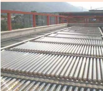
Εικόνα 16. Ηλιακοί συλλέκτες κενού στην οροφή του ερευνητικού κέντρου EURAC
