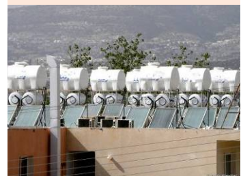
Εικόνα 12. Θερμικά ηλιακά συστήματα εγκατεστημένα σε οροφές κτιρίων στην Κύπρο Φώτο: Χρίστος Χριστοφίδης
