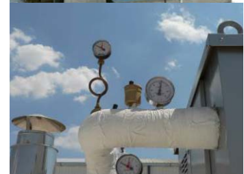
Εικόνα 19. Μηχανολογικός εξοπλισμός της πρώτης εγκατάστασης ηλιακού κλιματισμού - Αρτοποιείο L' Amor Rouge
