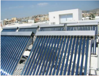
Εικόνα 5. Θερμικό ηλιακό σύστημα θέρμανσης χώρων στην Κύπρο
