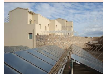
Εικόνα 21. Σύστημα θέρμανσης ZNX με ηλιακά πλαίσια σε ξενοδοχείο στη Κρήτη
