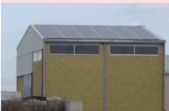
Εικόνα 26. Φωτοβολταϊκά πλαίσια σε οροφή βιομηχανικού κτιρίου στην Κύπρο
