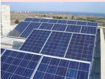
Εικόνα 24. Φωτοβολταϊκά πλαίσια σε οροφή κατοικίας στην Κύπρο
