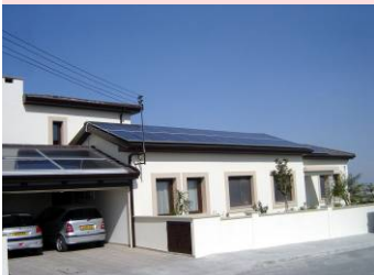
Εικόνα 25. Φωτοβολταϊκά πλαίσια σε οροφή κατοικίας στην Κύπρο
