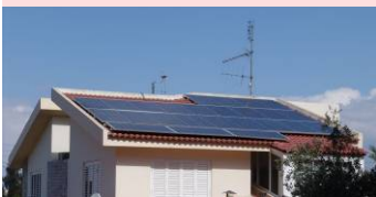
Εικόνα 27. Φωτοβολταϊκά πλαίσια σε οροφή κατοικίας στην Κύπρο
