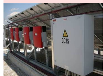
Εικόνα 21. Μετατροπείς (inverters) ΦΒ συστημάτων
