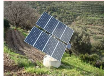
Εικόνα 18. Φωτοβολταϊκά στερεωμένα σε tracker (ανικνευτή πορείας του ήλιου)
