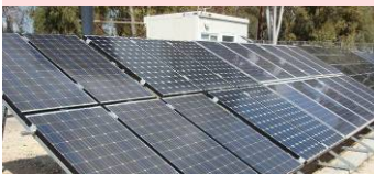
Εικόνα 23. Φωτοβολταϊκά πλαίσια διαφόρων τύπων εγκατεστημένα σε μεταλλικές βάσεις στο έδαφος, στο χώρο του εργαστηριακού ΦΒ Πάρκου στο Πανεπιστήμιο Κύπρου.
