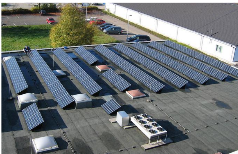
Εικόνα 2: Φωτοβολταϊκό σύστημα σε οροφή κτιρίου
