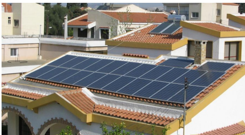
Εικόνα 1: Διασυνδεδεμένο φωτοβολταϊκό σύστημα σε στέγη οικίας στην Κύπρο
