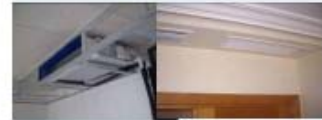
Σύστημα ψύξης με fan coils κατά τη φάση κατασκευής και μετά την ολοκλήρωση
